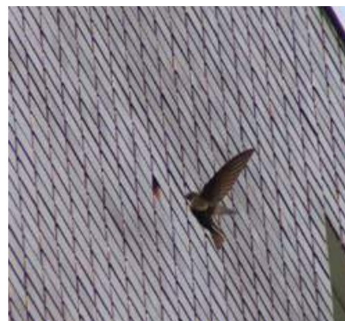
Gierzwaluwsteen weggevoerd in gevel
