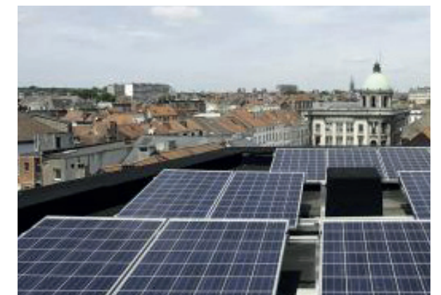
Dak met zonnepanelen
